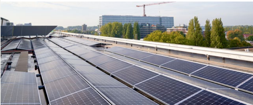
▶ Zonnepanelen op Edge Stadium Foto: Marcel Steinbach
